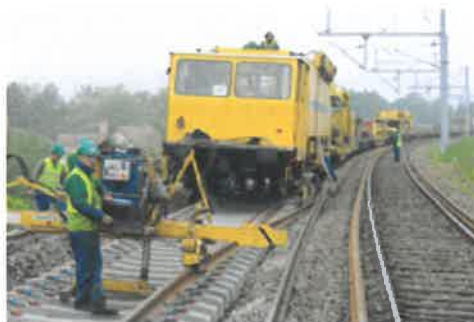
Longs Rails soudés sur traverses béton
